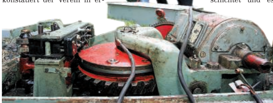
Zerstört: Auch diese Kabel der Weichenantriebskästen sind durchgeschnitten – es ist nicht der erste Anschlag auf die Parkeisenbahn. Foto: André Kempner
